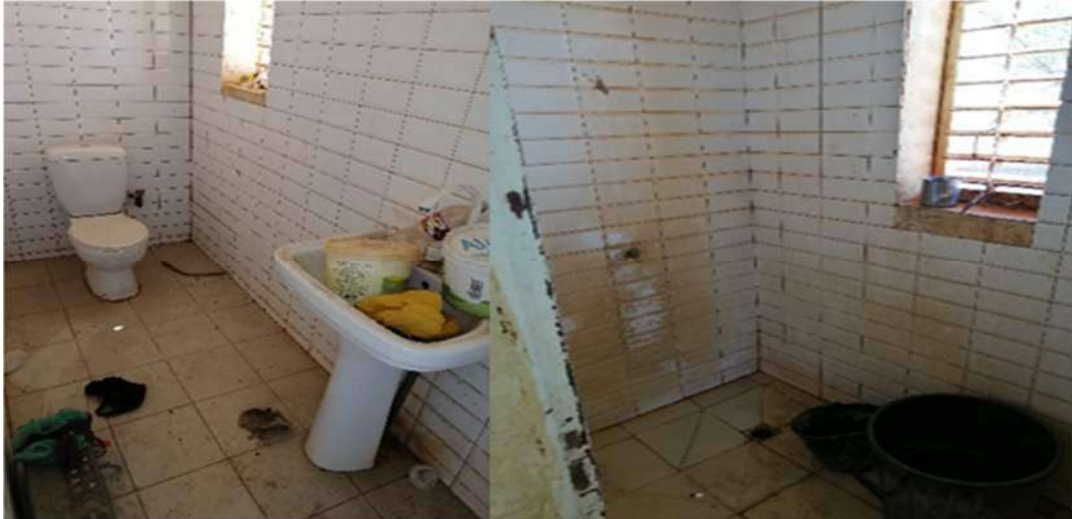
Toilettes mal entretenues, EDE, mai 2024
