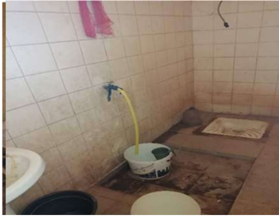
Toilettes mal entretenues, EDE, mai 2024
