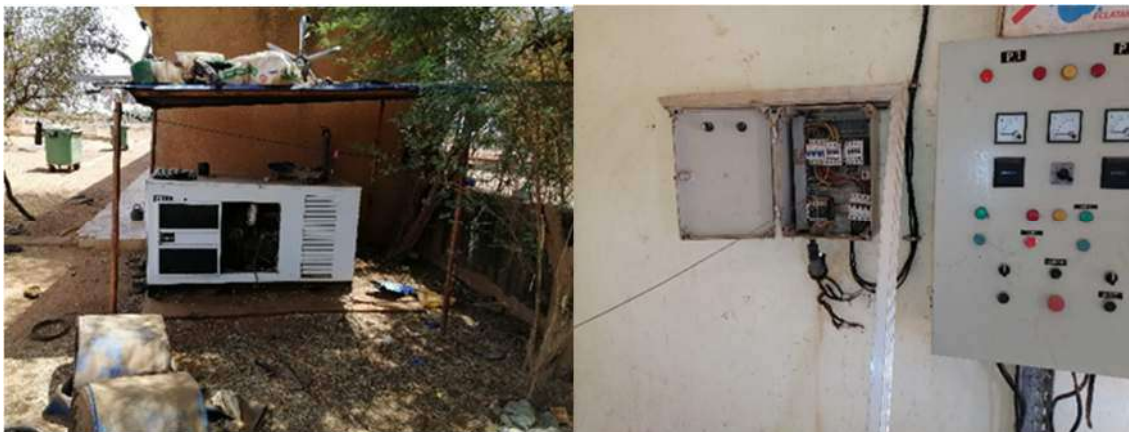
Groupe électrogène et installation électrique
