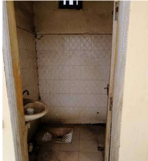
Toilettes très mal entretenues, EDE, mai 2024
