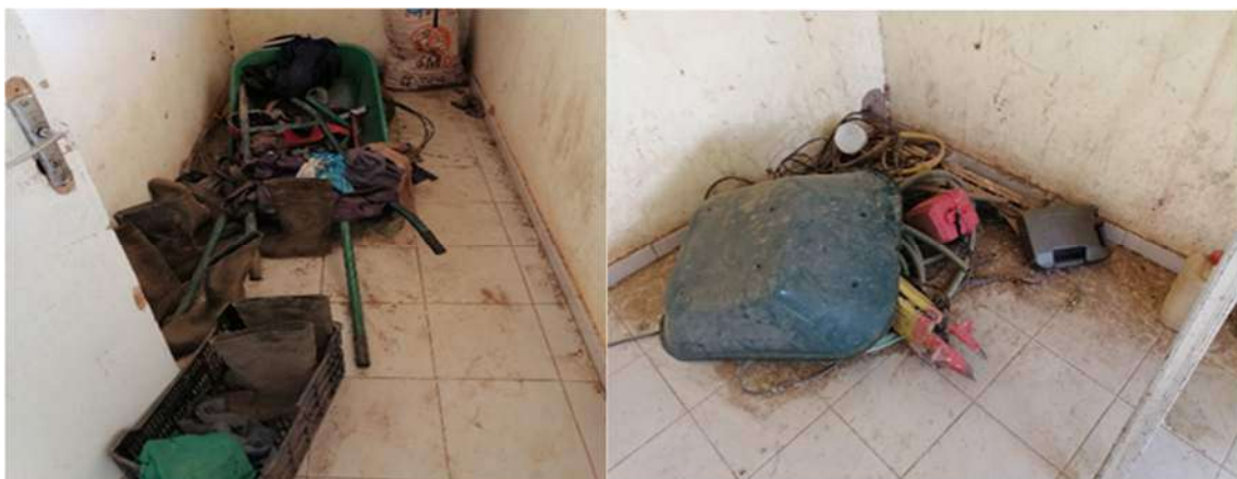
Défauts de rangement des équipements
