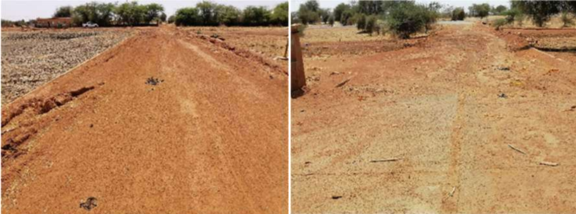
Mauvais état des pistes et absence de panneaux de signalisation de sorties/entrées camions, EDE, mai 2024
