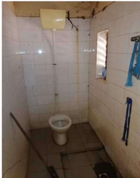
Toilettes mal entretenues, EDE, mai 2024
