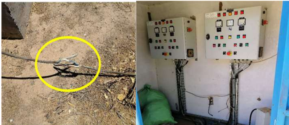
Gestion des installations électriques à améliorer, EDE, mai 2024
