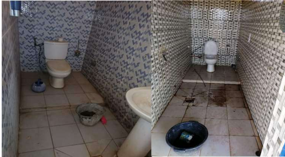
Toilettes mal entretenues, EDE, mai 2024
