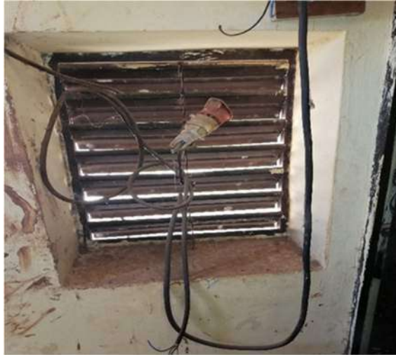
Installations électriques défectueuses, EDE, mai 2024
