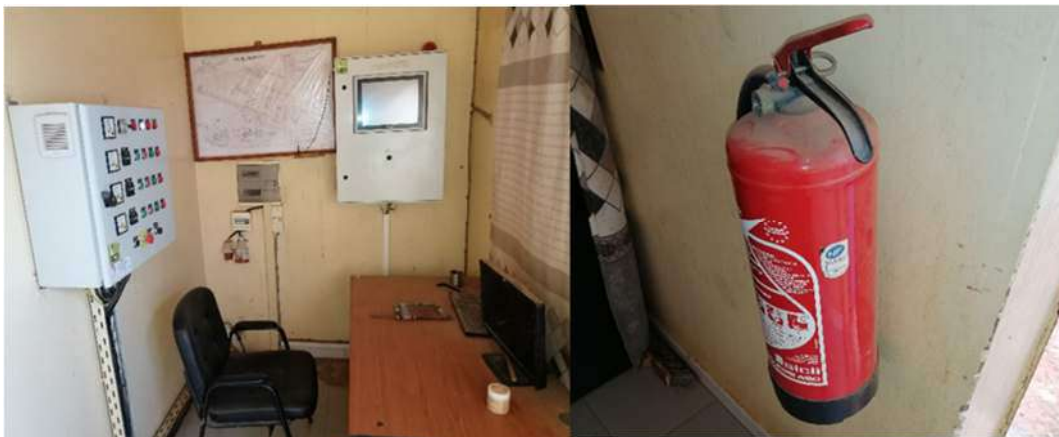
Installations électriques en bon état et présence d'extincteur
