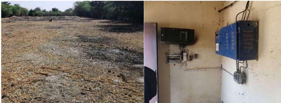
Risques d'incendies avec des installations électriques défectueuses et des traces brulis après un feu de nettoyage, EDE, mai 2024
