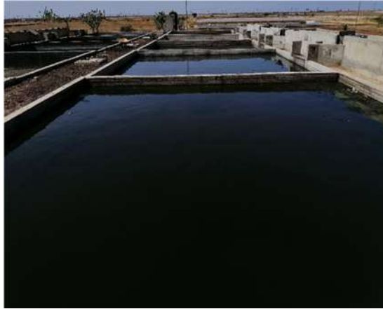
Absence de bouées de sauvetage pour les risques de noyade, EDE, mai 2024
