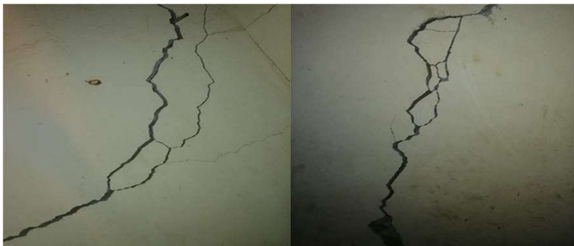
Fissures sur les murs des locaux techniques, mai 2024
