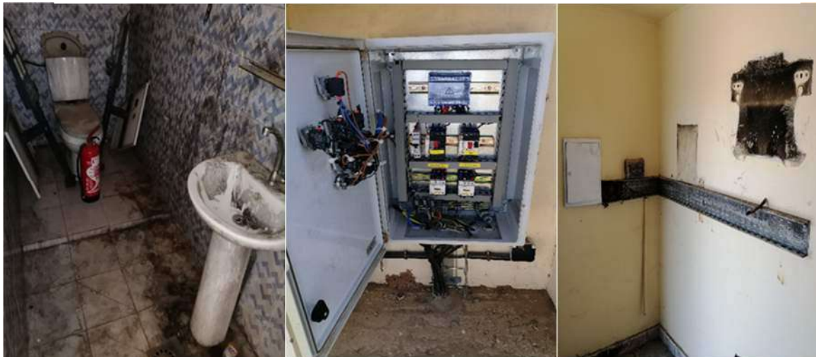
Installations électriques en bon état et présence d'extincteur, EDE, mai 2024
