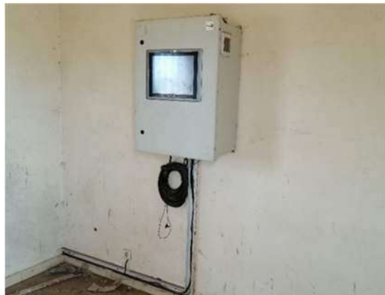
Installations électriques en bon état, EDE, mai 2024
