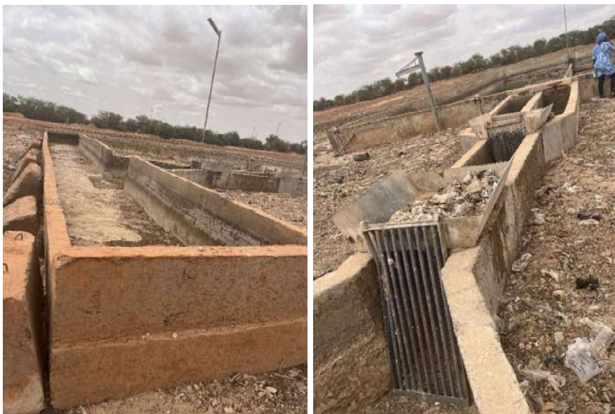
Photo 23 : Ouvrage de réception de la STBV de Touba
