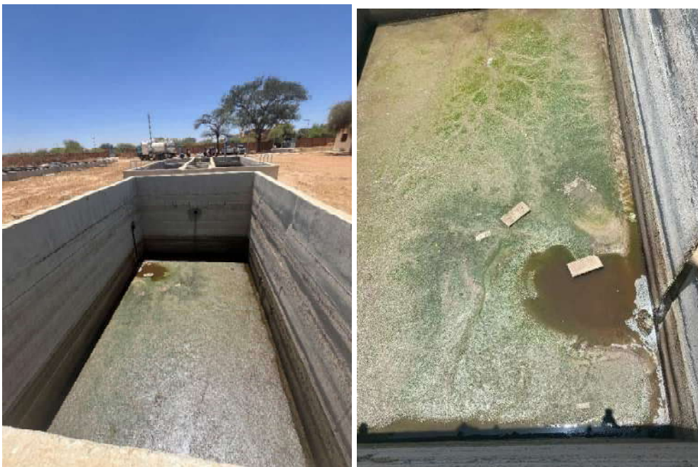
Photo 43 : Bassin tampon de collecte de la fraction liquide de la STBV de Louga
