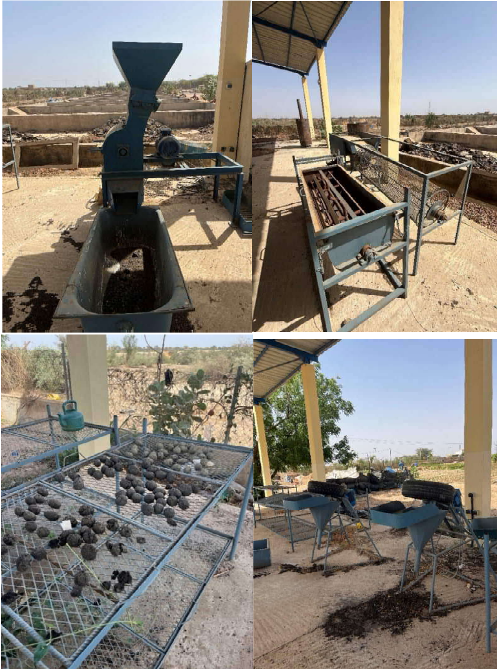
Photo 6 : Plateforme de valorisation des boues de la STBV de Tivaouane
