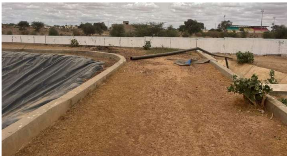
Photo 22 : Conduite de rejet des boues traitées vers la nouvelle STEP de Mbacké
