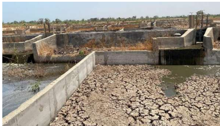
Photo 37 : Lits de séchage non plantés de la STBV de Joal en phase d'alimentation
