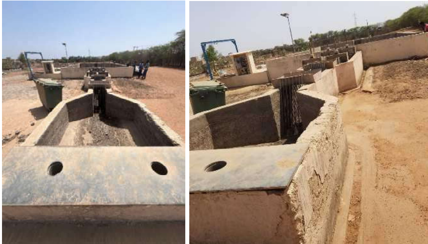
Photo 1 : Ouvrages de réception de la STBV de Tivaouane
