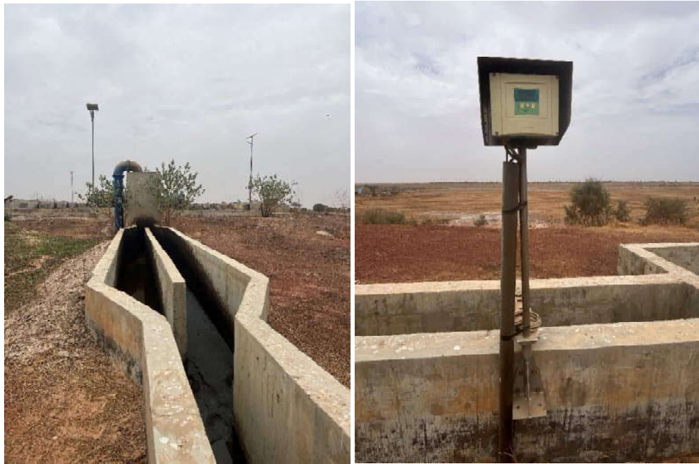
Photo 48 : Canal Parshall et débitmètre de la STBV de Fatick
