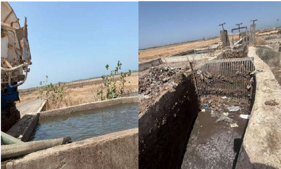
Photo 36 : Ouvrages de réception de la STBV de Joal
