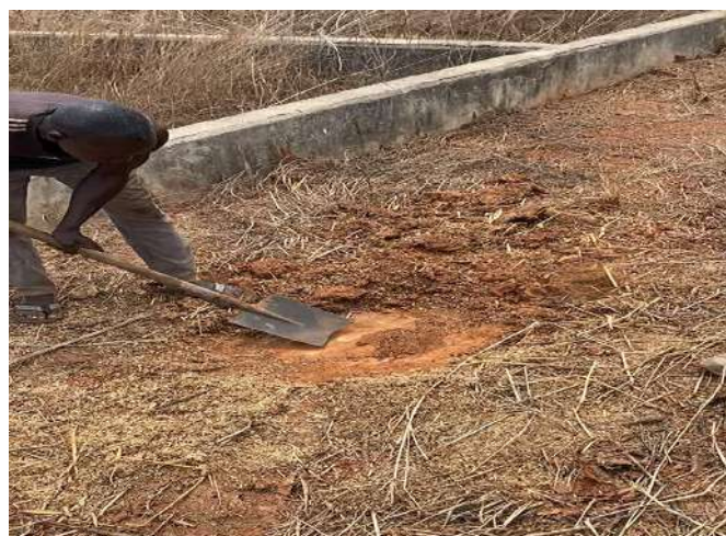
Photo 33 : Identification des regards de collecte des effluents de la STBV de Mbour
