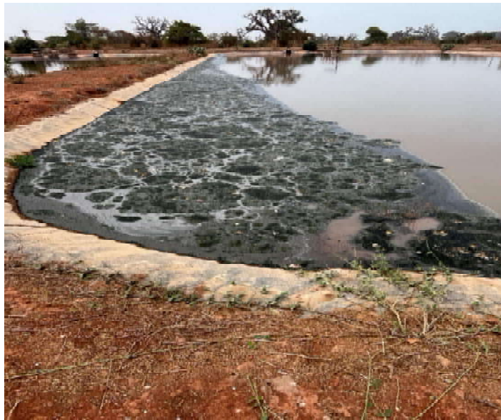
Photo 34: Bassin anaérobie de la STEP de Mbour
