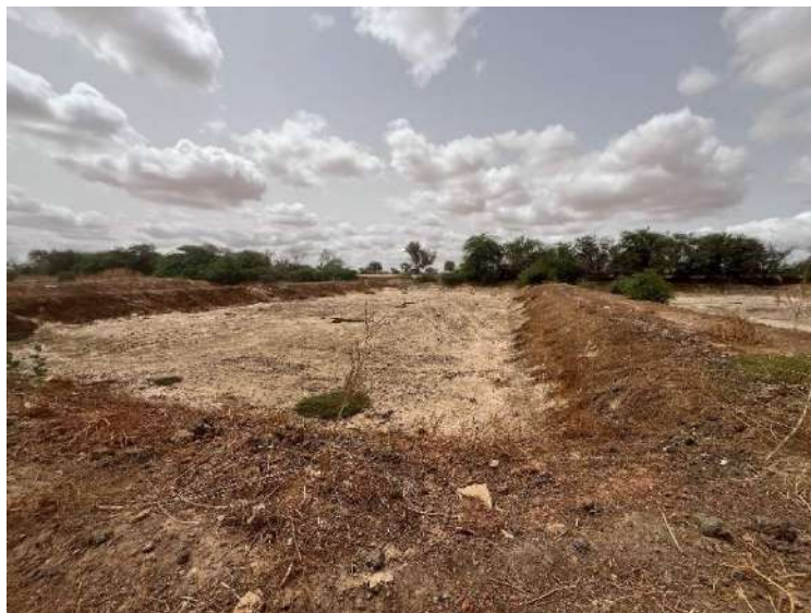
Photo 20 : Bassins d'infiltration de la STBV de Mbacké (1)
