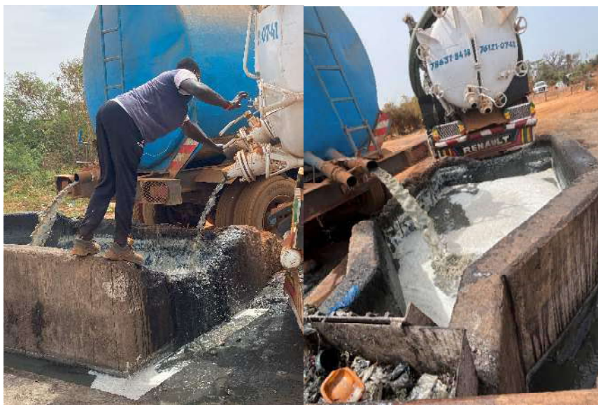
Photo 28 : Ouvrages de réception de la STBV de Mbour (1)
