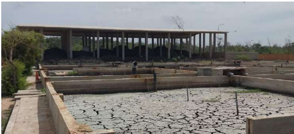
Figure 31 : Aire de séchage des boues à Tivaouane Peulh
