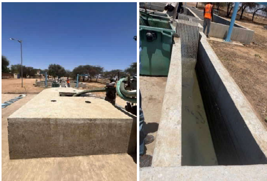
Photo 41: Ouvrage de réception de la STBV de Louga
