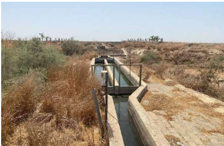
Photo 39 : Canal de transfert de la fraction liquide des boues vers la STEP de Joal
