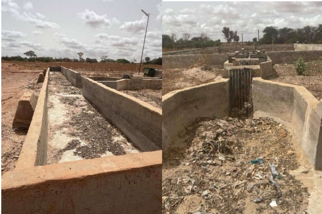
Photo 16 : Ouvrages de réception de la STBV de Mbacké
