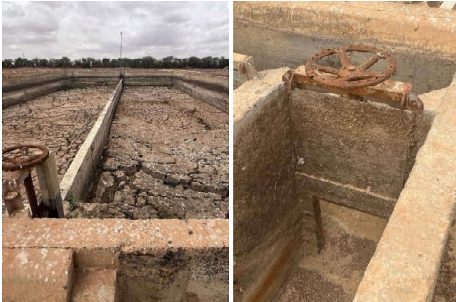
Photo 24 : Bassin de sédimentation de la STBV de Touba
