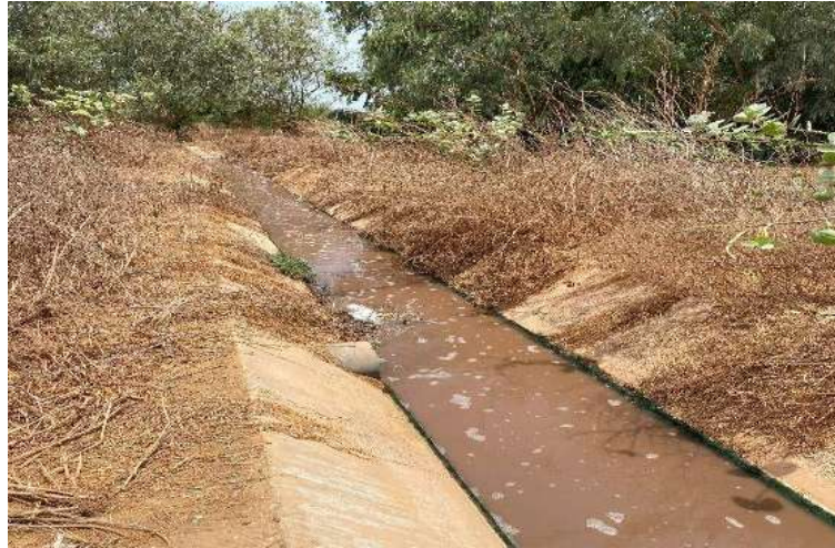
Photo 35 : Canal de rejet des eaux traitées de la STEP de Mbour
