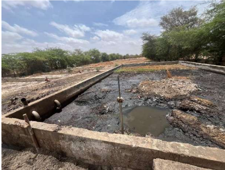
Photo 11 : Bassin de sédimentation de la STBV de Diourbel
