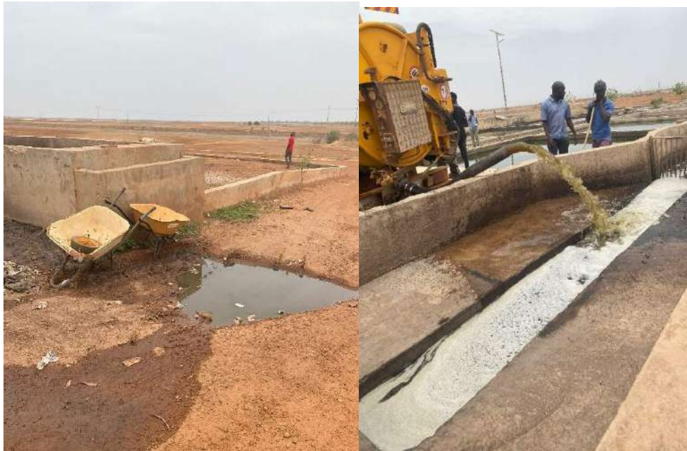
Photo 46 : Ouvrages de réception de la STBV de Fatick
