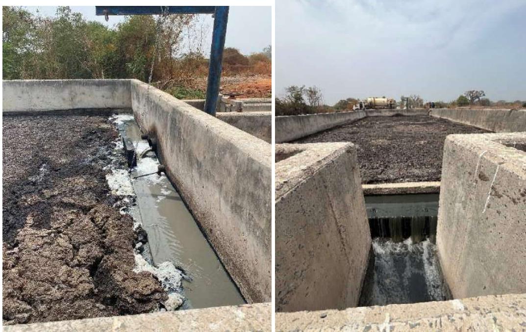
Photo 31 : Bassin de sédimentation de la STBV de Mbour
