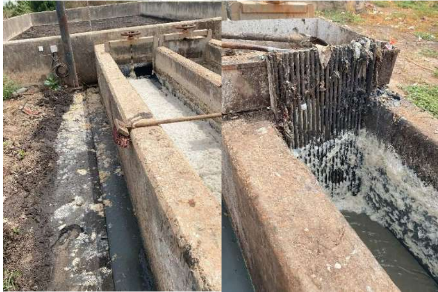
Photo 29 : Ouvrages de réception de la STBV de Mbour (2)
