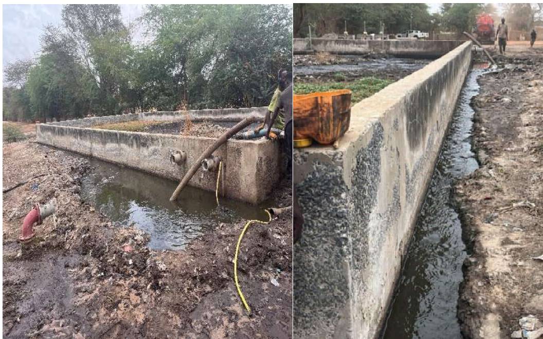
Photo 10 : Dépotage des boues à la STBV de Diourbel
