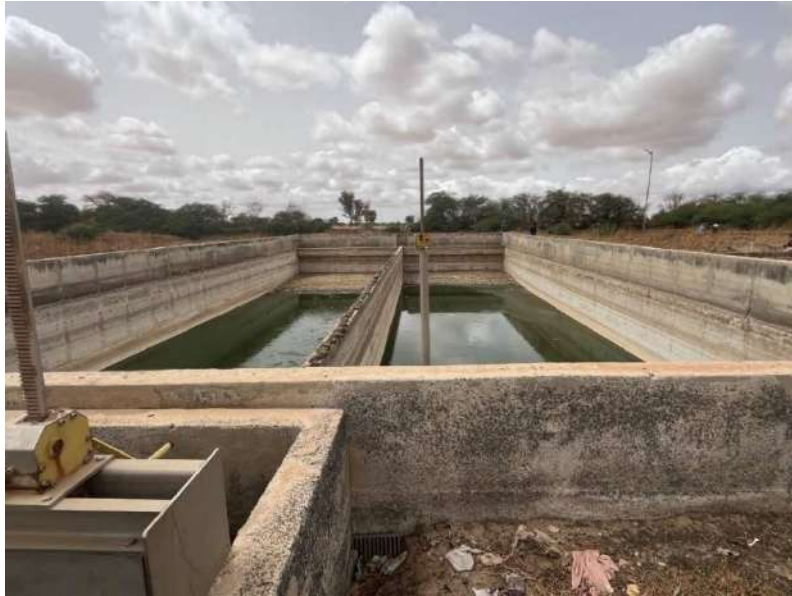
Photo 17 : Bassin de sédimentation de la STBV de Mbacké
